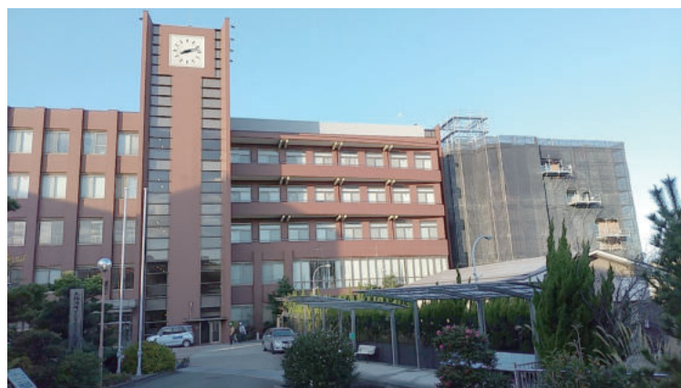
5階建て研究科棟は、本館北側(中央環状道路側)に隣接して建設されており、本館とは各階廊下で接続される。大阪河崎リハビリテーション大学正門から撮影(2021年12月23日)
